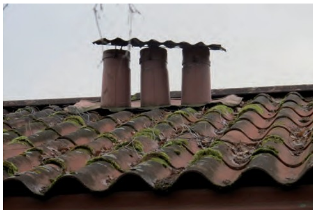
Kuva 32. Päiväkoteja yhdistävän katoksen katto on asbesti-pitoista mineraliittiä. KuvaSHi.
