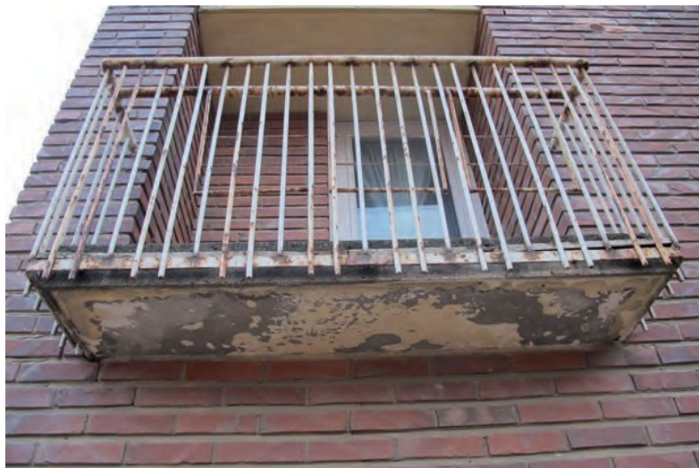
Kuva 31. Kalevan päiväkodin parvekkeen betonilaatta on kärsinyt kosteudesta. Teräskaide on ruostunut. Kuva SHi.
